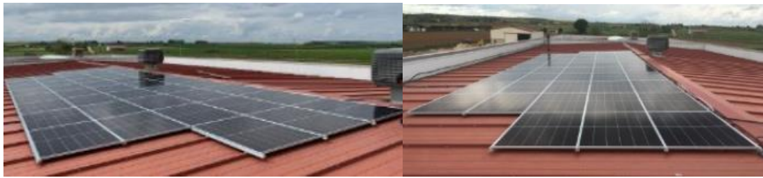
INSTALACIÓN INDUSTRIAL USO PÚBLICO. Madrid (colegio Hnos. Gcía. Noblejas). 15Kw
