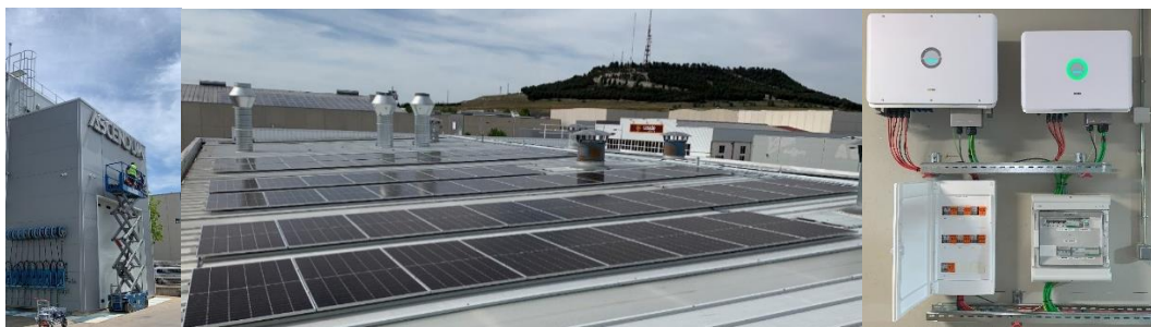
INSTALACIÓN INDUSTRIAL. Aranjuez (fábrica de BOSCH). 50Kw
