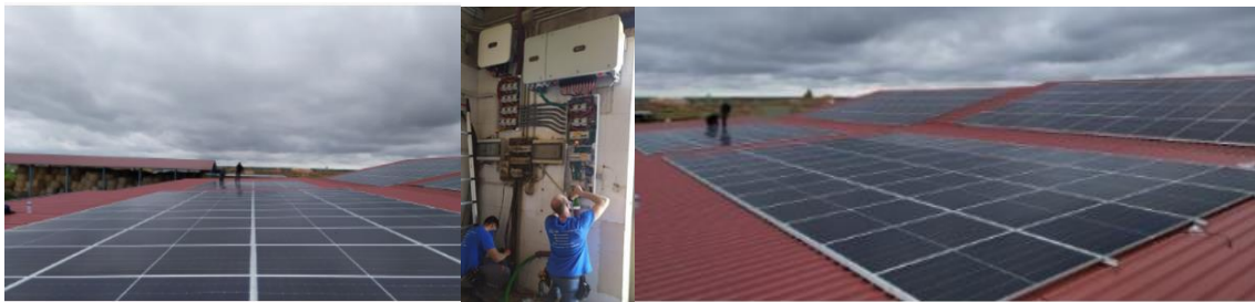
INSTALACIÓN INDUSTRIAL. Valladolid (ASCENDUM. Grupo VOLVO). 70Kw
